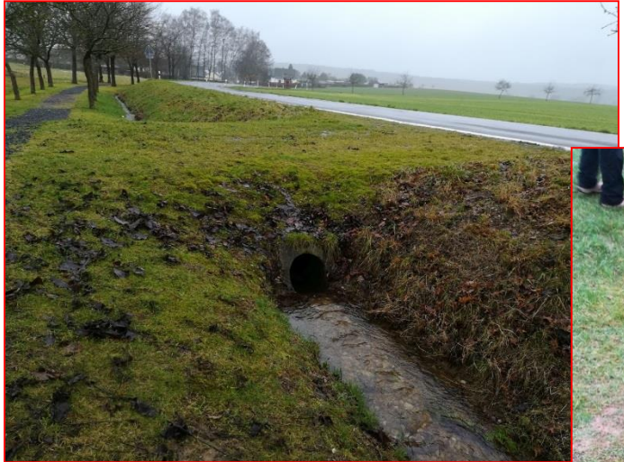
Überlastung des Grabens
