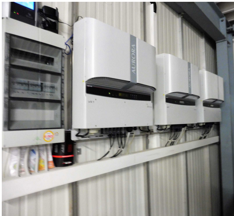
□ Halle 1 PV Anlage
