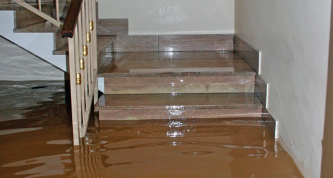
Abb. 16: Überfluteter Keller nach Starkregen
